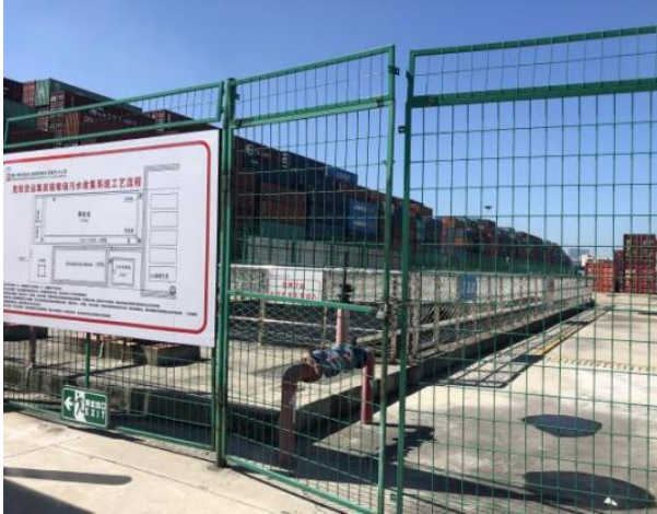
现状危货堆场废水收集沉淀、事故池等
